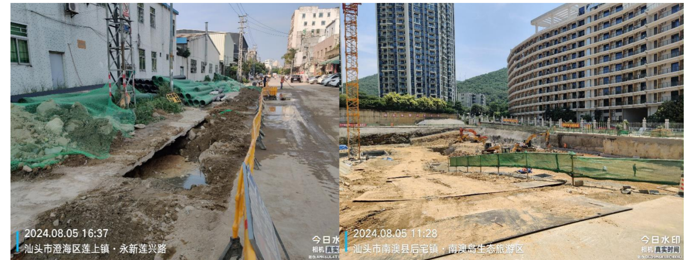
a) 市政项目未进行减量管理或采用再生建材 b) 房建项目未进行减量管理或采用再生建材
