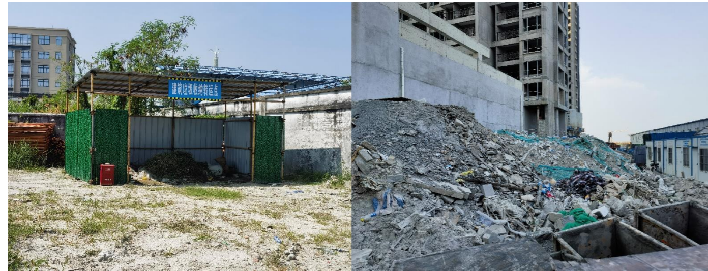
a) 未合理设置建筑垃圾分类暂存点
