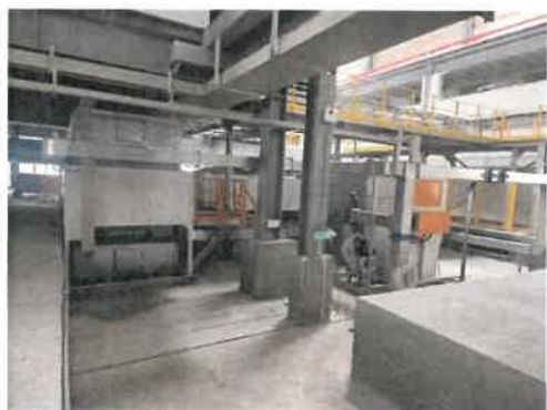
(4) 拆解厂房催化燃烧
