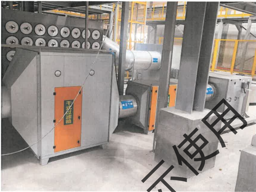
图 4.8 干式过滤器及活性炭吸附塔
