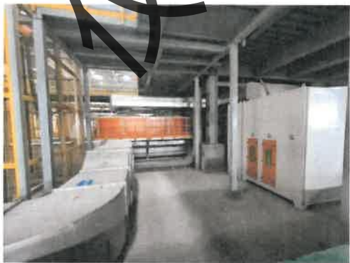
(3) 拆解厂房催化燃烧
