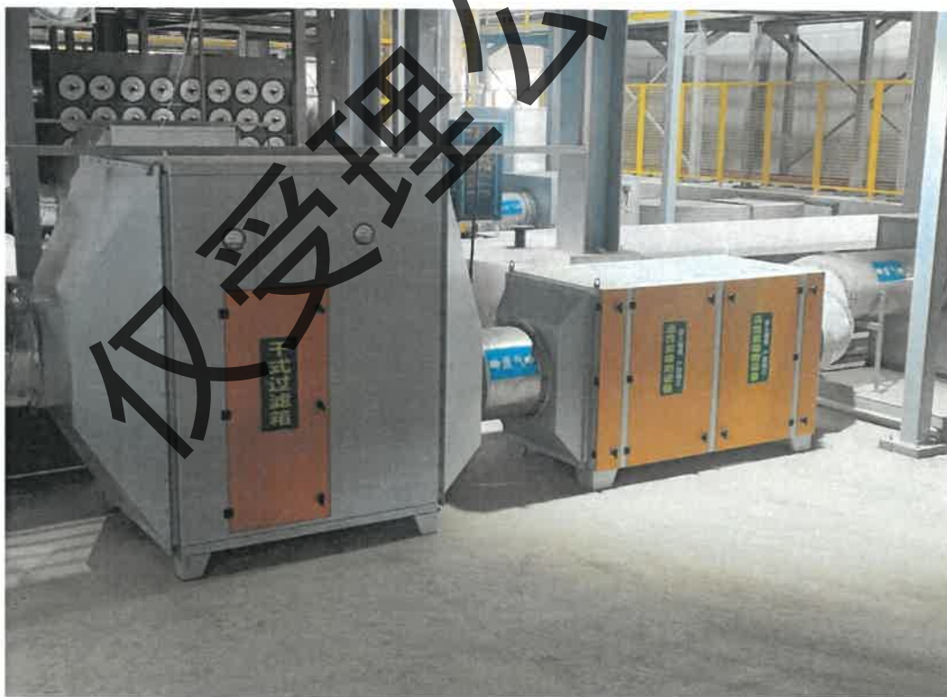
图 4.7 干式过滤器及活性炭吸附塔
