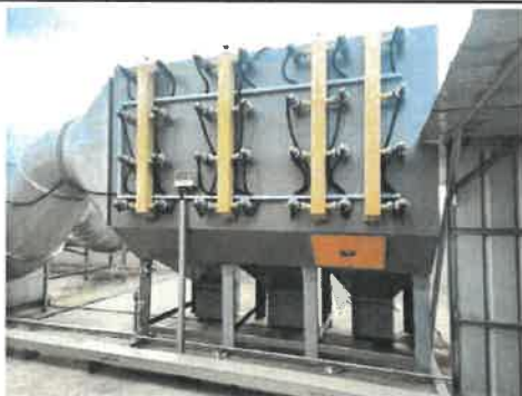
(5) 通用厂房滤筒除尘器
